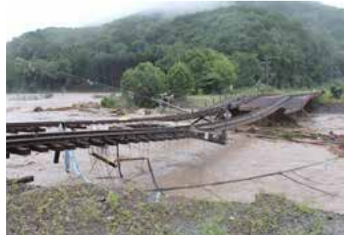
崩壊した線路鉄橋（31日撮影）
