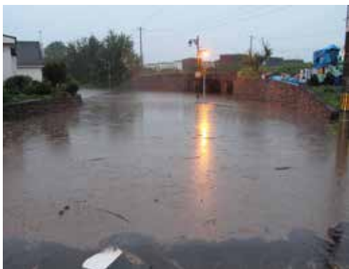
水没した南2丁目アンダーパス（31日撮影）
