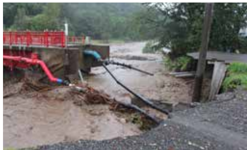
崩壊した神社橋（31日撮影）
