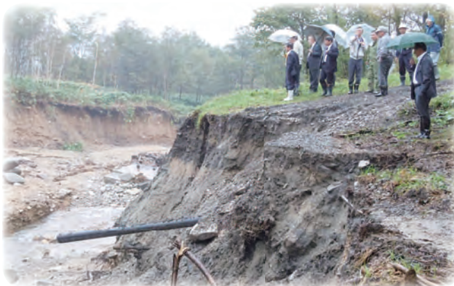
長期間断水の原因となった取水口全壊現場
